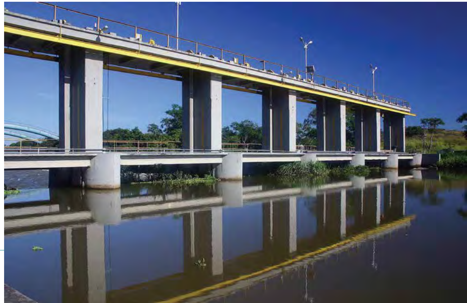
Estrutura de captação e distribuição de água no Sistema Guandu (Foto: Cosme Aquino)
